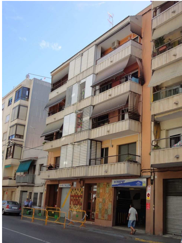
DIRECCION DE OBRA DE LA REFORMA DE FACHADA EN LA CALLE JOSEP COROLEU DE VILANOVA I LA GELTRU. BARCELONA
